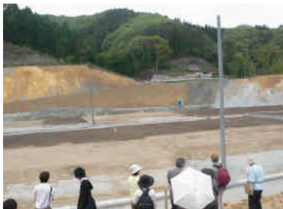
電柱ばかりが目立つ造成地 水道はまだひけていない (撮影 深澤宏介)
